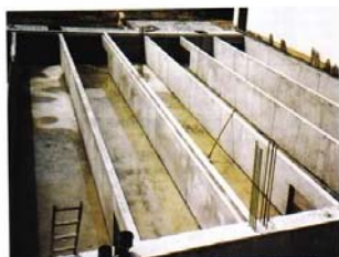
Kanali za skladištenje gnojovke ispod staje („stalom sistem“)
